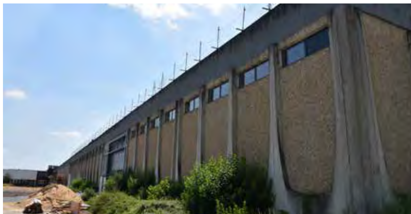
Installation de l'entreprise Alumis dans la Zi Nord à Arnas
