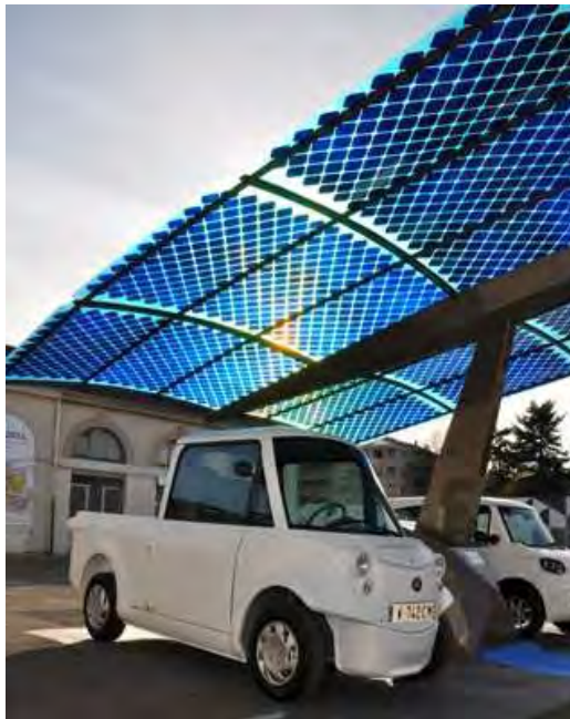
« Ombrières » photovoltaïque sur un parking Source internet www.avem.fr
